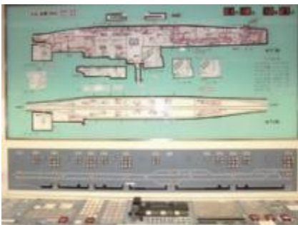
地下線防災監視盤
