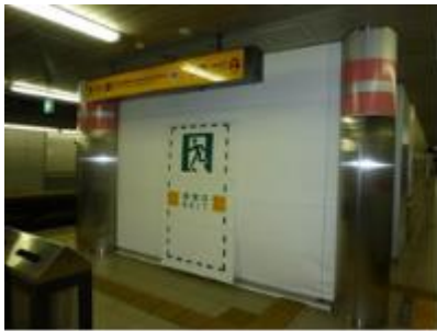
防火防煙シャッターが下りた状態
