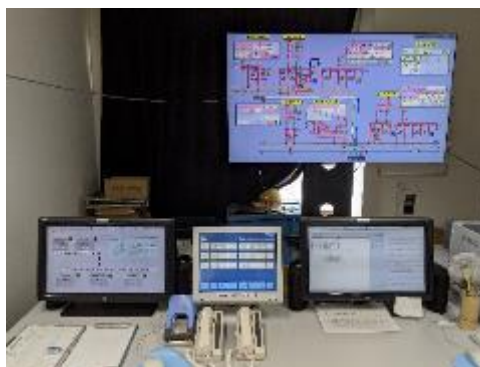
電力管理システム
