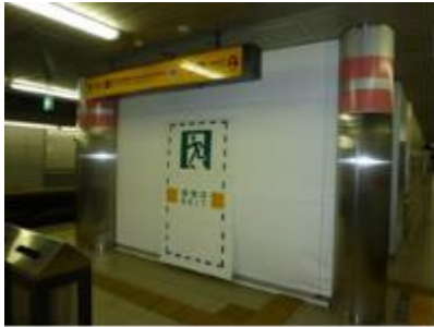
防火防煙シャッターが下りた状態
