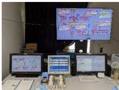
電力管理システム
