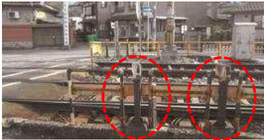
自動車侵入検知装置
