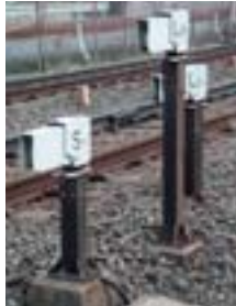
踏切障害物検知装置 ▶
