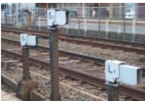
踏切障害物検知装置
