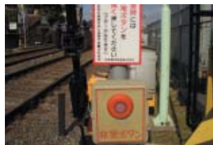
踏切支障報知装置
