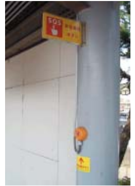
ホーム異常通報装置
