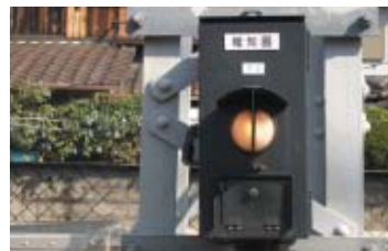
作業用列車接近報知器
