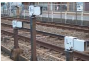
踏切障害物検知装置
