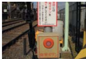
踏切支障報知装置
