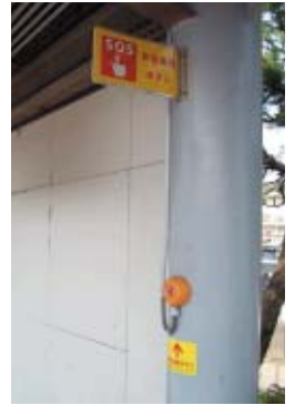
ホーム異常通報装置
