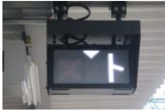
戸閉合図装置 (ホーム上屋に設置)
