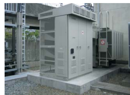
▲ヒートパイプ整流器
