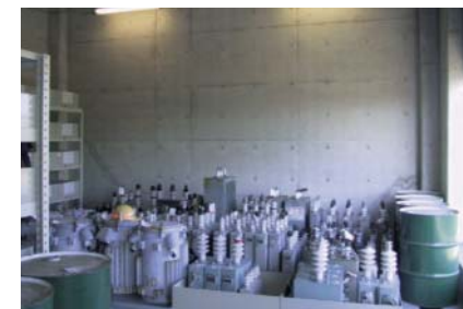
▲PCB保管庫内の廃棄物機器保管状況
